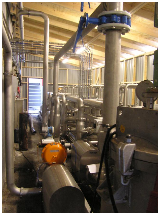
FIGUR 1: BILLEDE AF PILOTANLÆGGET I BYGNING.
